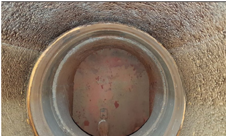
Всасывающая труба, внутреннее покрытие, после 10 лет эксплуатации – Права на иллюстрацию: компания «bremenports GmbH & Co. KG»
