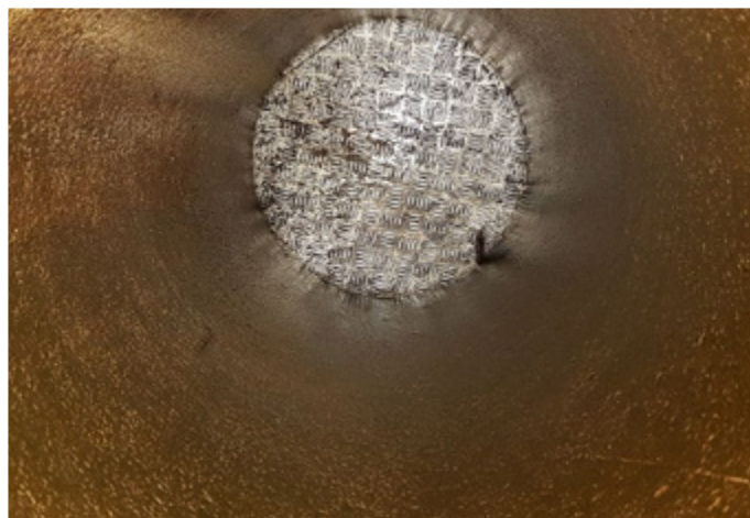
Внутреннее покрытие промежуточной детали после 10 лет эксплуатации Права на иллюстрацию: компания «bremenports GmbH & Co. KG»
